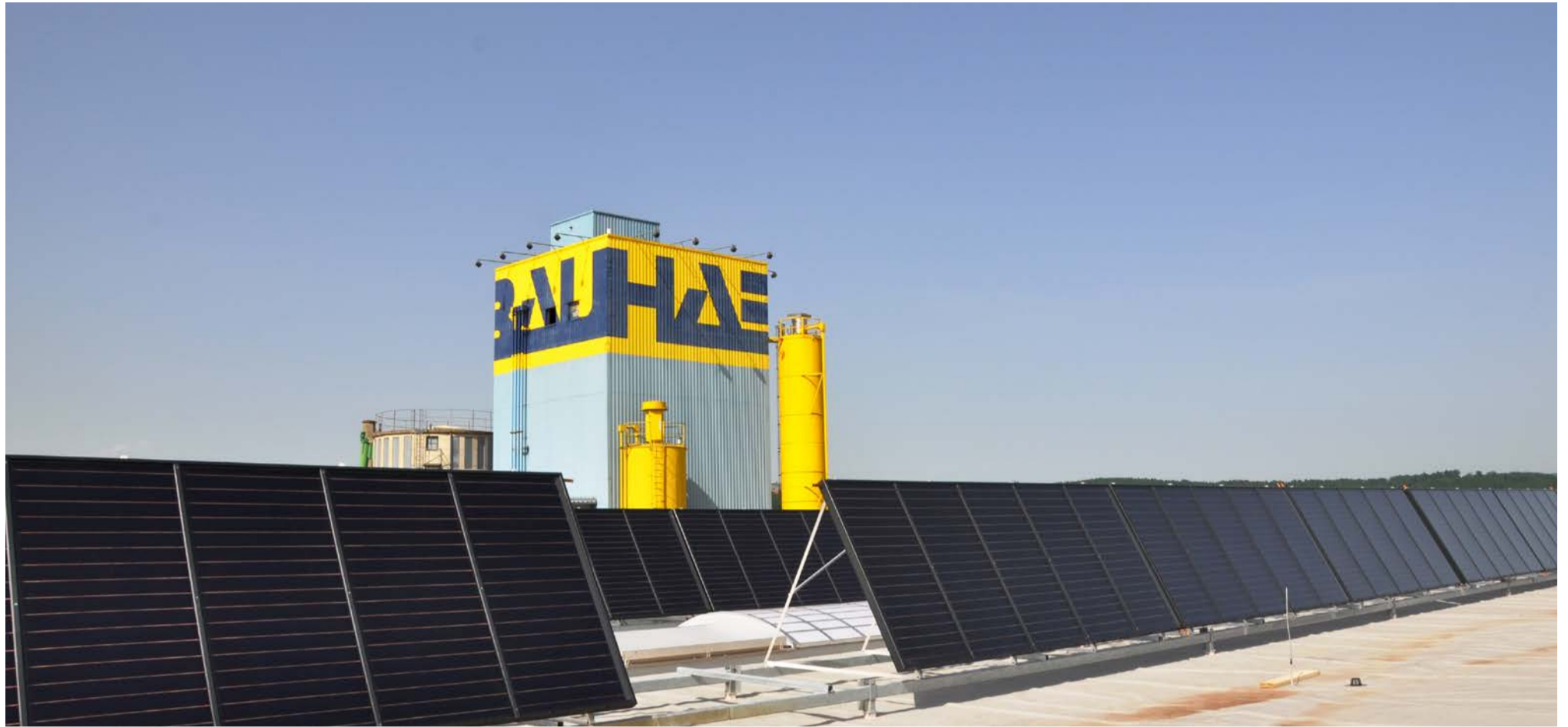
Die 1.410 m 2 große thermische Solaranlage mit Betonteilaktivierung ermöglicht einen Wärmeenergieertrag von 590.000 kWh pro Jahr.
