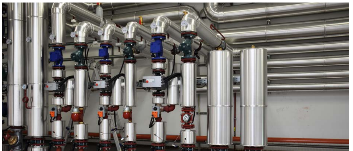
Niedrige Rücklauftemperaturen aus dem Betonspeicher führen zu einem außerordentlich hohen Wirkungsgrad. Foto: HABAU
